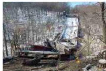
フーン・ホロー橋崩落 (2022年) (国家運輸安全委員会 (NTSB) HPより)
