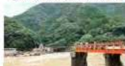
令和2年7月豪雨、熊本県道
