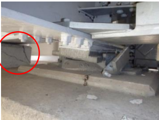
写真-6 支承の破損の状況
