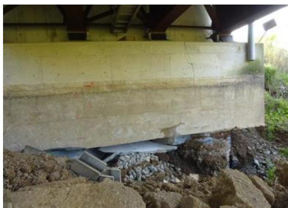
写真-2 橋台周辺の地盤 変状による橋台の沈下 たわらやま (県道熊本高森線・俵山大橋)
