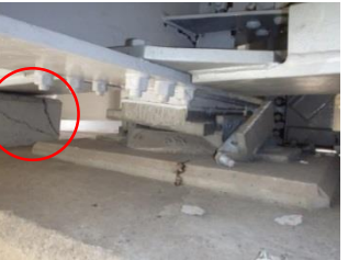
写真-6 支承の破損の状況
