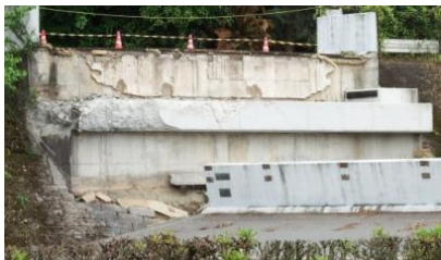
写真-2 横変位拘束構造の破壊、落橋（県道小川嘉島線・府領第一橋）
