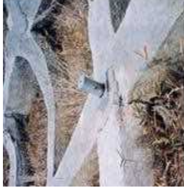
写真 受圧構造物の破損の例
