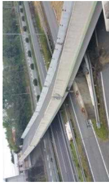
ロッキング橋脚を有する橋の落橋
