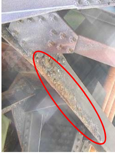
耐候性鋼材に層状の剥離
