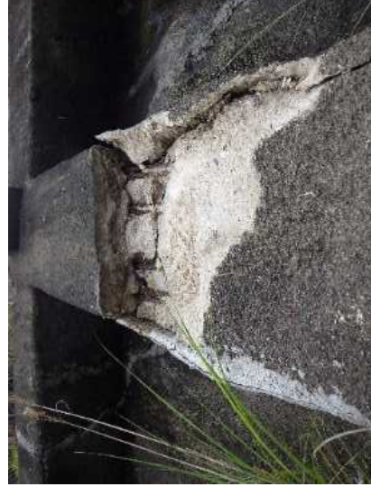
法枠工の老朽化損傷
