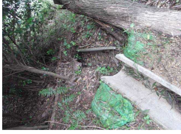
写真 排水溝の破損の例
