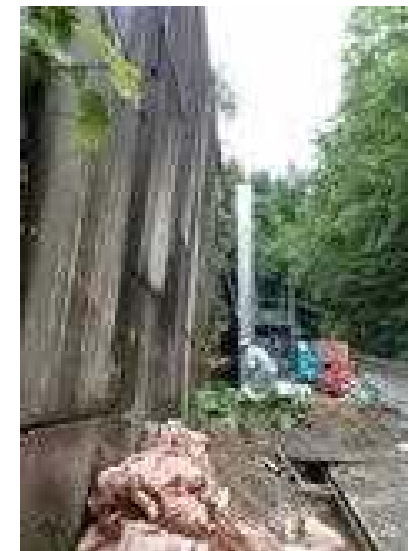
写真 壁面の傾斜の例
