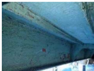
桁の塗装劣化やさびの発生
