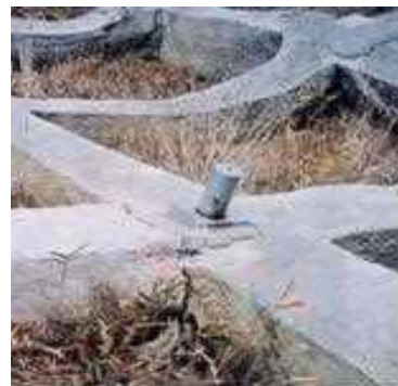
写真 受圧構造物の破損の例
