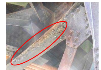
耐候性鋼材に層状の剥離
