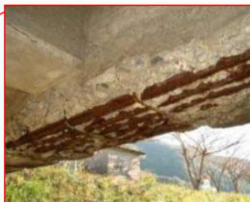
主桁の剥離、鉄筋露出
