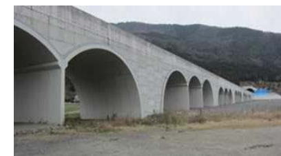
アーチカルバート
