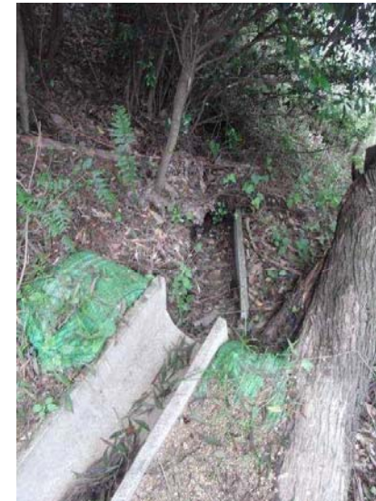
写真 排水溝の破損の例
