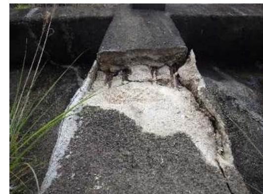
法枠工の老朽化損傷
