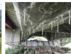
主桁のひびわれ
