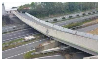
ロッキング橋脚を有する橋の落橋
