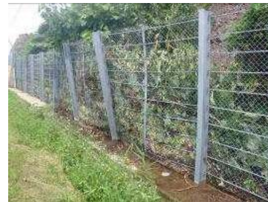
写真 落石防護柵の傾動の例
