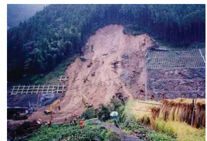
強風化・土砂化斜面での崩壊例
