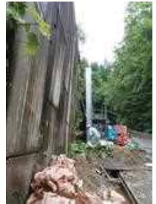
写真 壁面の傾斜の例
