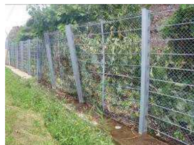
写真 落石防護柵の傾動の例
