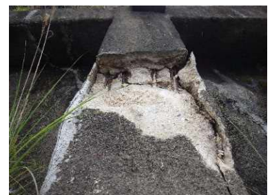
法枠工の老朽化損傷
