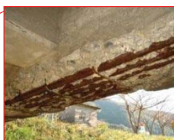
主桁の剥離、鉄筋露出
