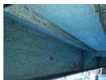
桁の塗装劣化やさびの発生
