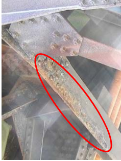
耐候性鋼材に層状の剥離
