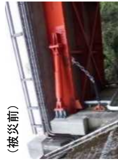
制震ダンパー取付部の損傷
