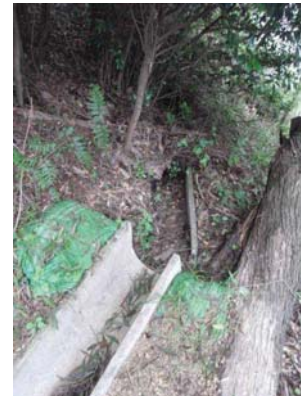
写真 排水溝の破損の例
