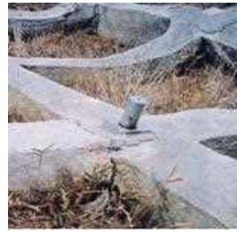
写真 受圧構造物の破損の例
