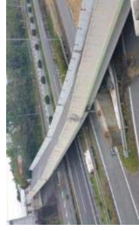
写真-8 ロッキング橋脚を有する橋梁の落橋(府領第一橋)
