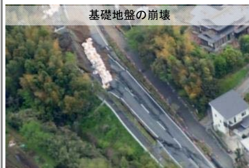
写真-9 国道443号 (益城町)
