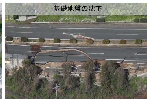
写真-10 九州自動車道 (益城町)
