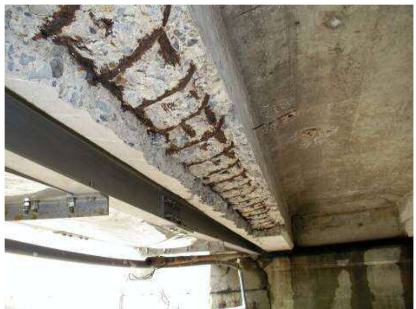
塩害により主桁に発生した コンクリート剥離による鉄筋の露出
