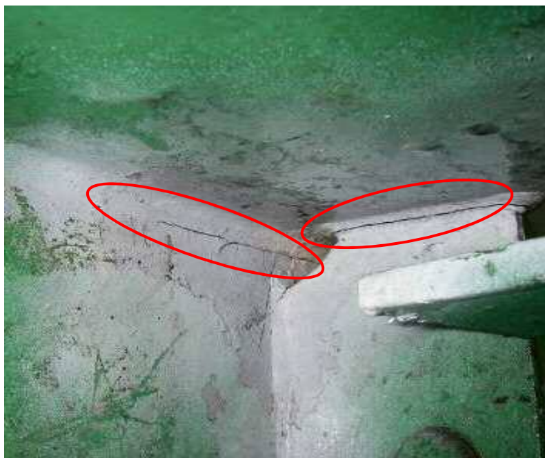
主桁の鋼部材に発生した疲労亀裂
