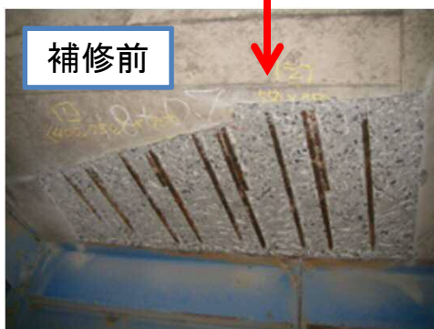
床版下面の損傷 (コンクリートの剥落・鉄筋露出)
