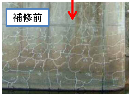
橋脚の損傷(ひびわれ)
