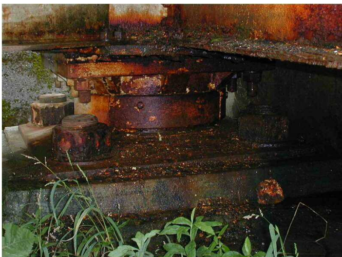
支承の損傷（腐食）
