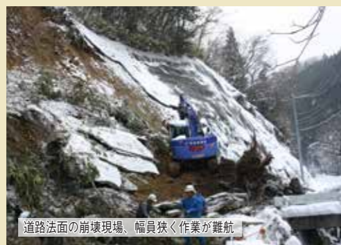
道路法面の崩壊現場、備員狭く作業が難航
