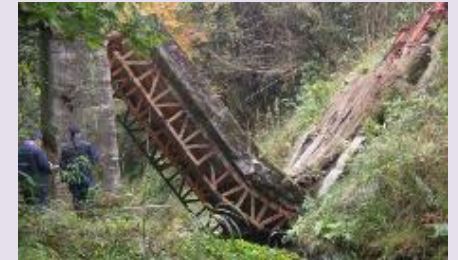
香川・徳島県境無名橋の落橋 (2007年)
