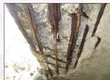
III判定（床版 鉄筋露出状況）
