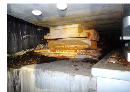
支承（腐食、堆砂状況）
