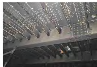
写真-3 鋼床版被災状況(塗膜)
