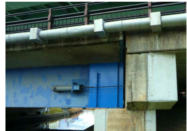
桁端部の腐食と部分塗装事例
