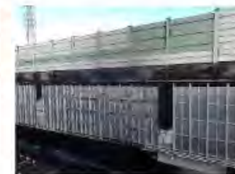
写真5 足場の損傷状況[側面から]
