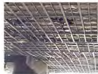
写真4 足場の損傷状況[下面から]
