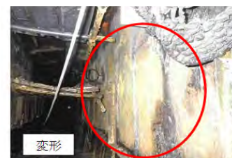
写真-1 G2桁Web被災状況(変形)
