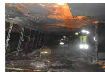
写真-2 G2桁被災状況(塗膜)
