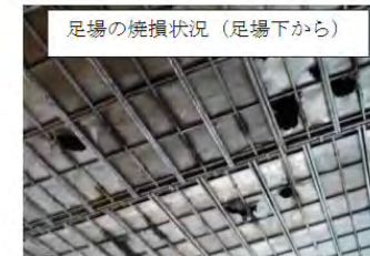
写真-4 仮設足場被災状況(下り線)
