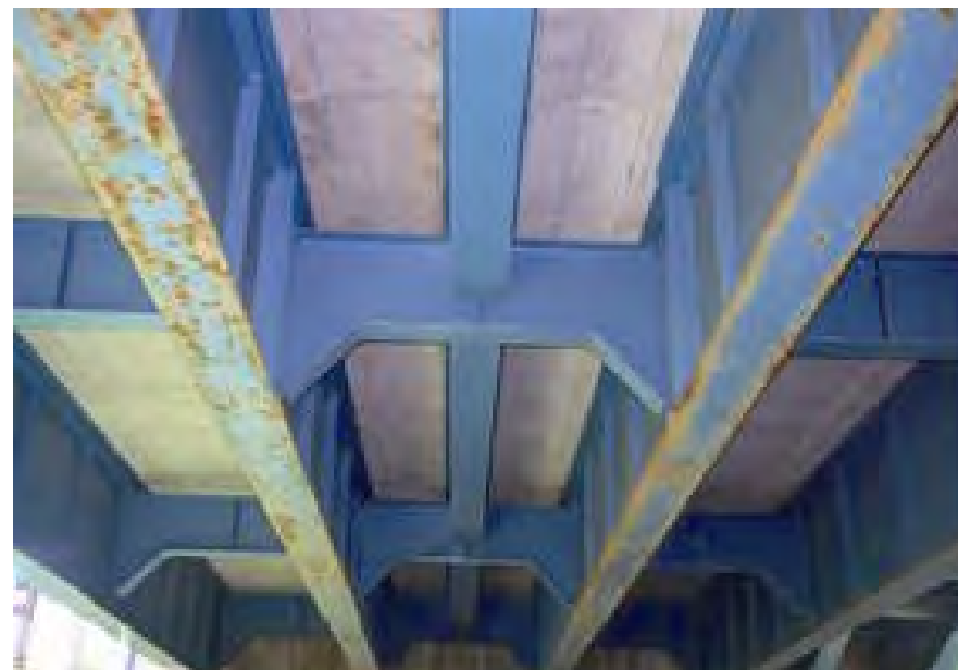
写真-I.2.2 エッジ部の腐食
