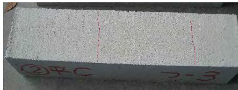
暴露3年でのひび割れ
