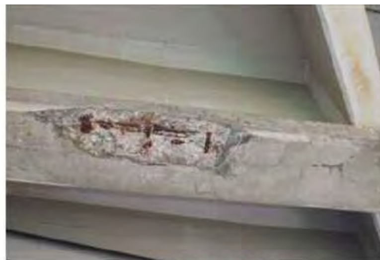
b) 断面修復材の剥落後
