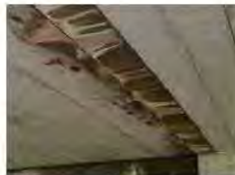
構造目地からの漏水により塩害が生じた事例
