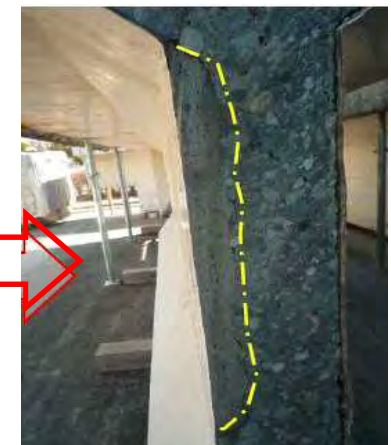
桁の切断面（断面修復部が見える）
