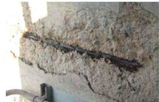
c) 浮きコンクリートを剥がしたところ、鉄筋腐食による浮きであったことを確認（かぶり厚さは3～4cm）
