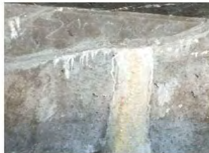
ひび割れ充填後（約1年後）の析出物
