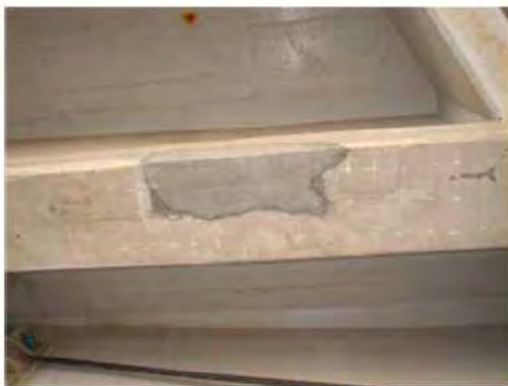
a) 断面修復材の剥落前
