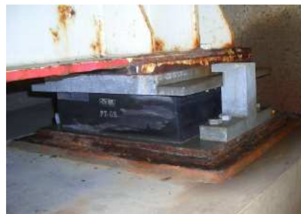
漏水による鋼部材の腐食 (ゴム支承)
