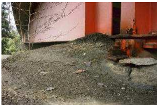
支承部の土砂堆積
