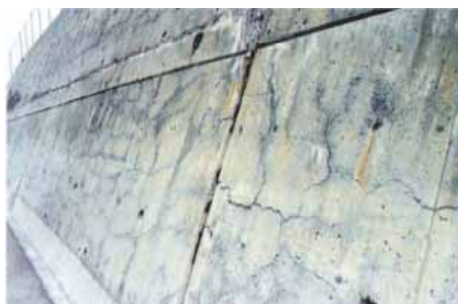
写真-1 亀甲状のひび割れ
