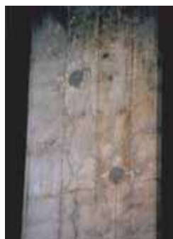
写真-2 鋼材に沿ったひび割れ
