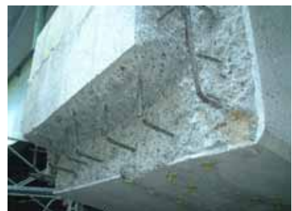
写真-5 鉄筋破断状況
