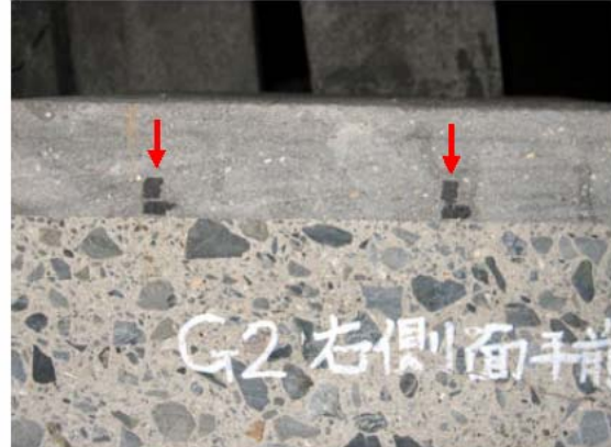
《柱基礎部から1,200mm付近》
