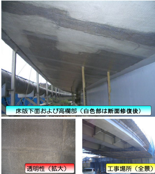
写真4 跨線橋【既設】一スケはく
