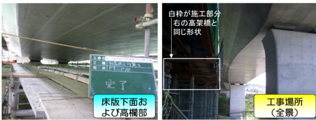
写真5 高架橋【新設】一スケはく
