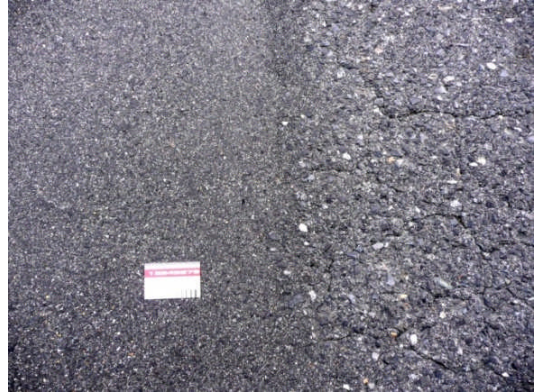
写真-3 左側リフレッシュシール (ひび割れがない) と右側既設舗装 (ひび割れ路面)
