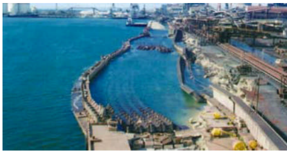
写真-1 側方流動による被災事例（出所：株神戸製鋼所）
