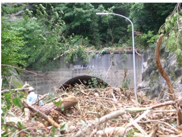
写真-2 被災状況2
