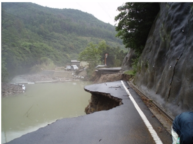
写真-1 被災状況1
