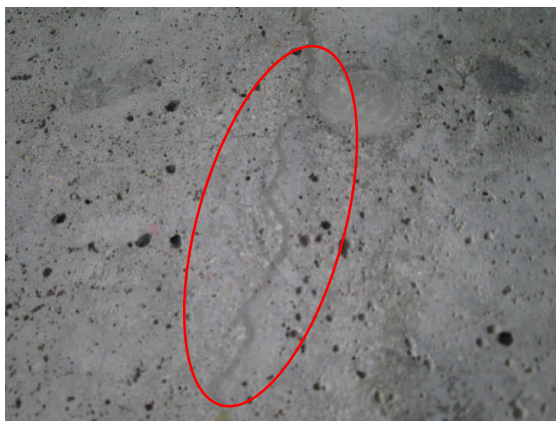
図-11 ひび割れ注入跡の状況
