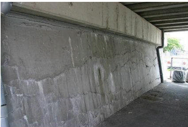
図-1 表面処理によるASR補修後の再劣化事例
