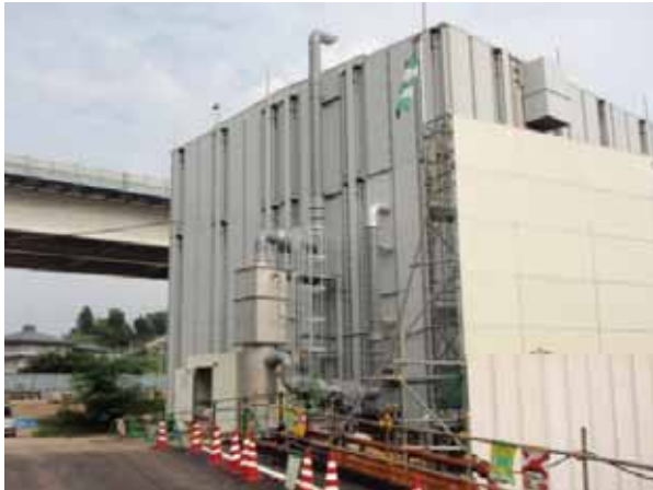
写真-3 排気ラインオゾン処理設備全景
