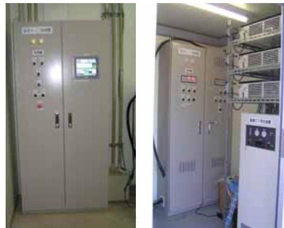
写真-6 オゾン発生装置・管理制御盤
