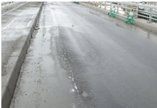
写真-1 鋼床版舗装の損傷事例
