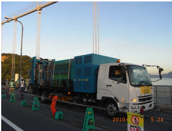
写真-2 I H式加熱機（2号機）
