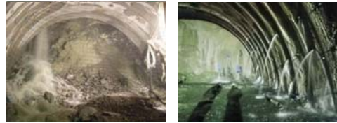
掘削時の切羽からの大量湧水状況
