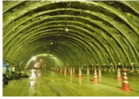
減水対策工実施後の坑内状況 (天端等からの滴水はほとんど見られない)
