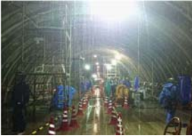
減水対策工実施前の坑内状況 (作業時には雨合羽が必要)
