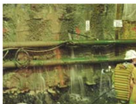
注入前の湧水状況
