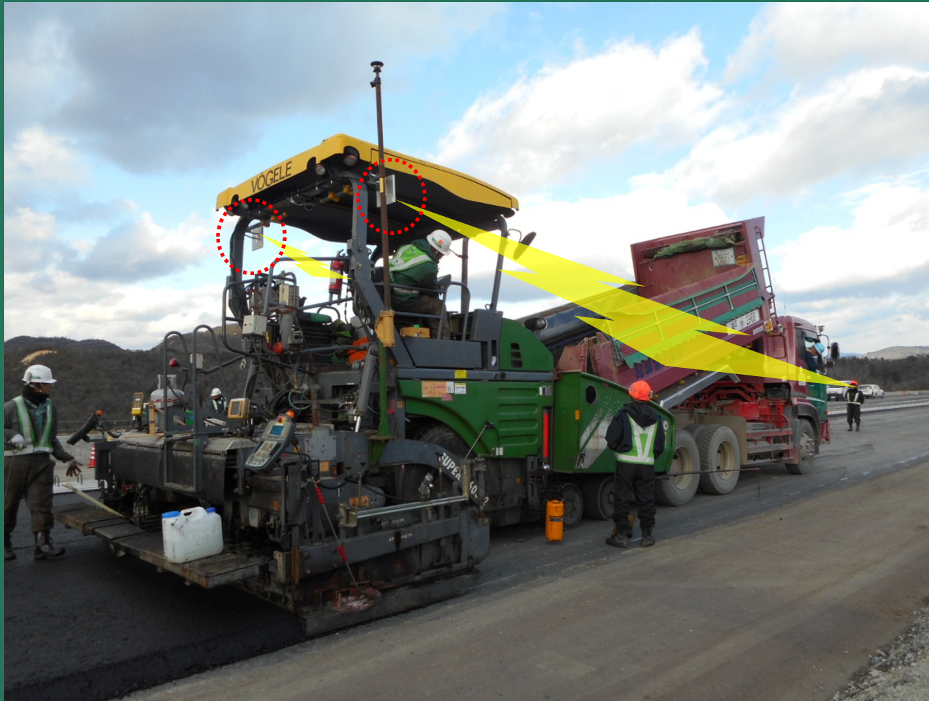
アスファルトフィニッシャにWi-Fiアンテナ設置
