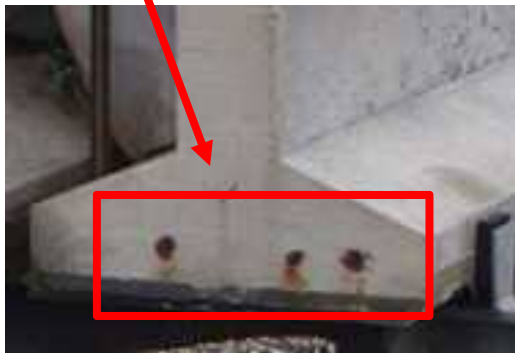
端部のPC鋼材が腐食
