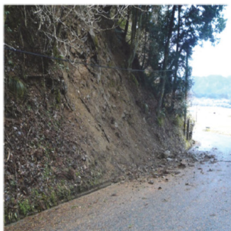
施工前：斜面崩壊
