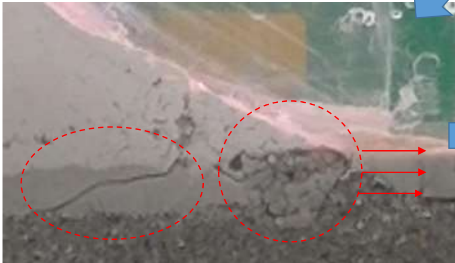
・ 810s, 水みち発生, 対策工の移動
