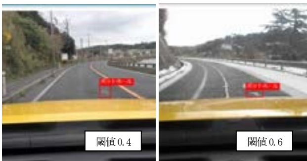
図-6 閾値による損傷取得事例（ポットホール）
