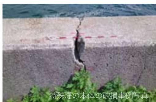
図-3 誤登録事例① 特殊堤本体の破損
