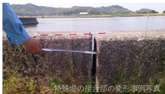
図-4 誤登録事例② 特殊堤接合部の破損
