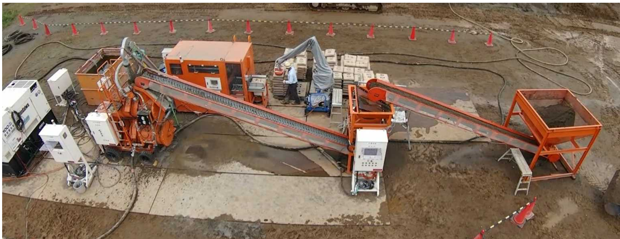
ショットセ이버（自動吹付プラント）の全景
