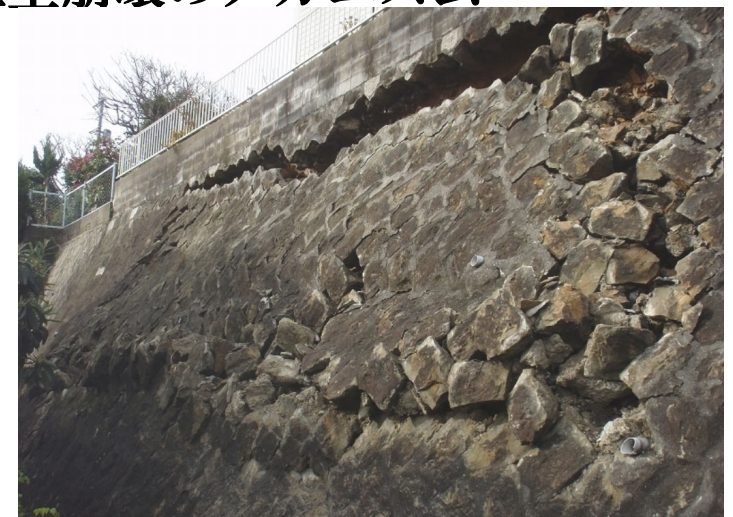
補修した空石積擁壁の崩壊事例
