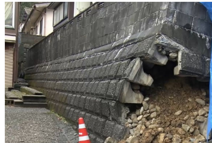
空石積擁壁の崩壊被害 (2024年能登半島地震：新潟県糸魚川)
