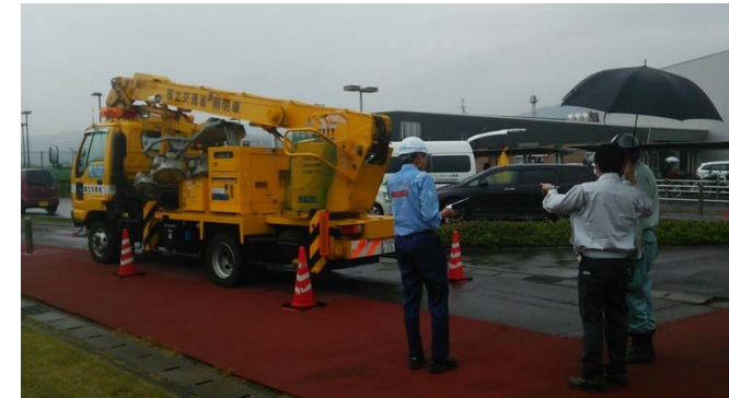
照明車 設置箇所を避難所職員と調整
