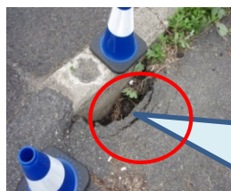
◇歩道での空洞の事例
