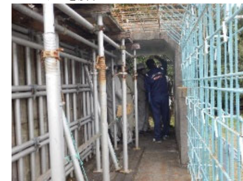
施工不良モデルの説明(自治体職員) 鉄筋コンクリート構造物（施工中、施工後） に起こりやすい事象のモデルを展示
