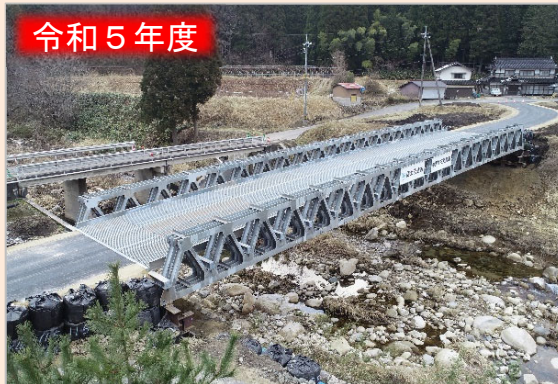
令和5年台風7号(岡山県鏡野町) 鏡野町要請 応急組立橋無償貸与
