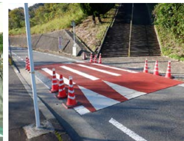
令和7年10月 本郷西小学校前設置
