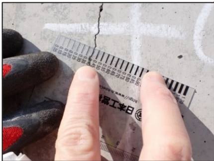
※正面のひび割れ状況も同様
