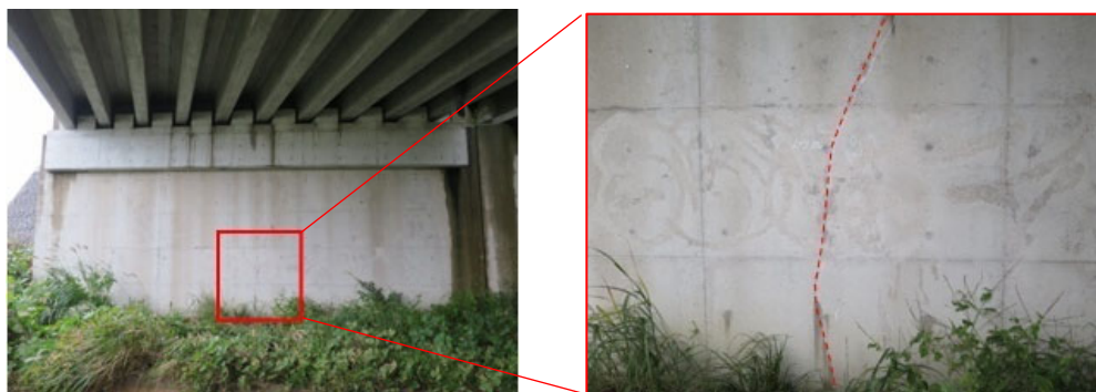
図 1.2 橋台に発生した温度ひび割れ 1) p.21
