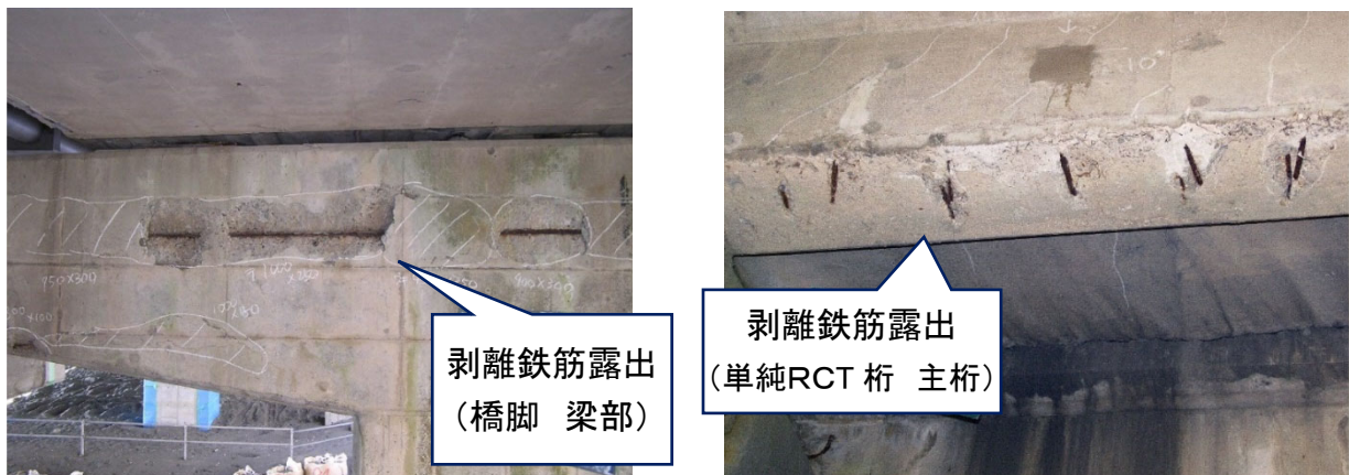
写真 かぶり不足に起因する損傷例
