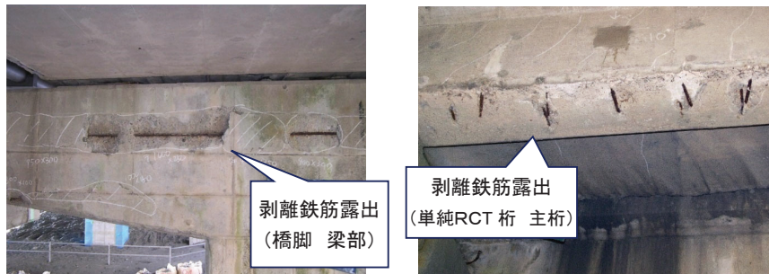
写真 かぶり不足に起因する損傷例
