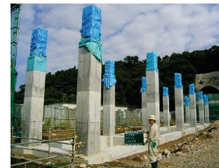
図 鉄筋露出部をブルーシートで保護した例（高架橋における柱とスラブの接合部）
