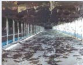
塗料剥離状況
