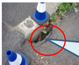
◇歩道での空洞の事例
