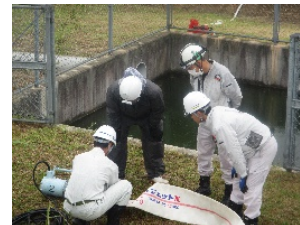
R3訓練状況（排水ポンプ車）
