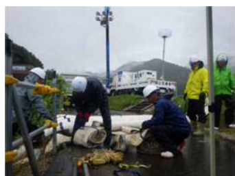
令和3年8月豪雨 活動状況 (広島県内)
