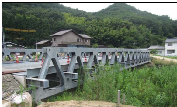
平成30年9月より派遣中の応急組立橋状況 (岡山県小田郡矢掛町)
