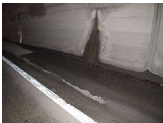
漏水による路面滞水
