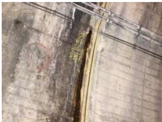
横断目地部付近からの漏水
