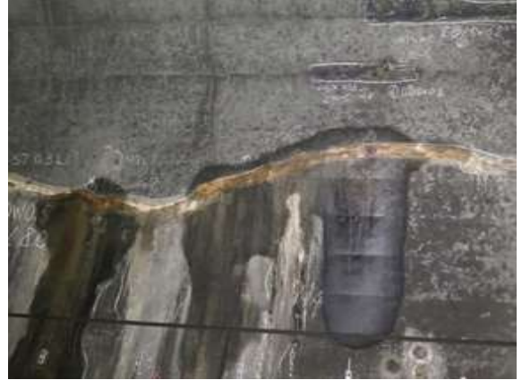
漏水を伴ったひび割れ
