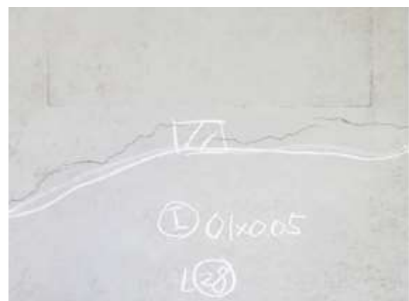
ひび割れ沿いのうき
