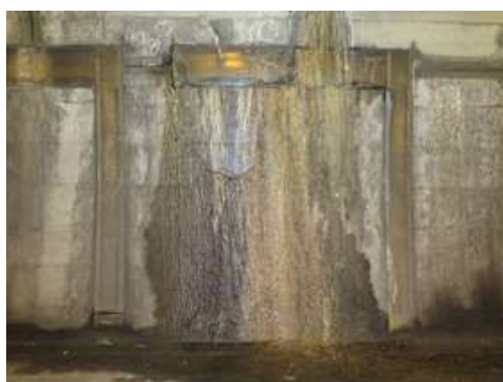
水平打継目部からの漏水
