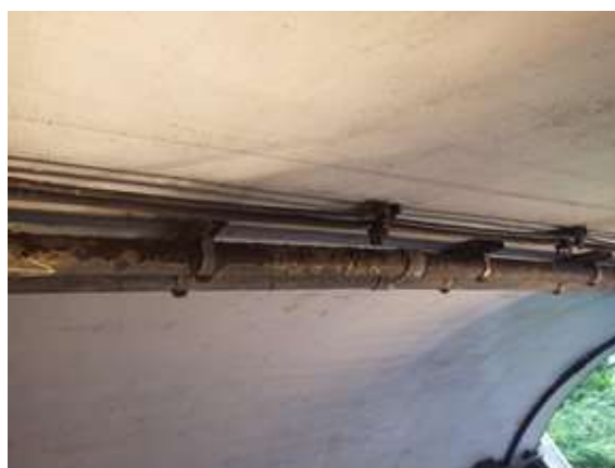
ケーブル保護管腐食
