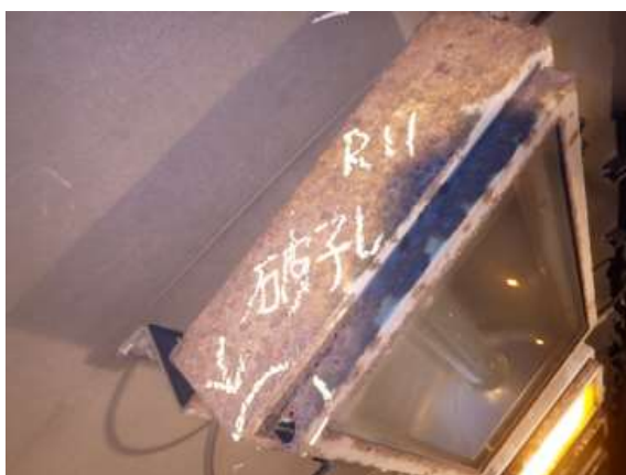
照明器具の腐食
