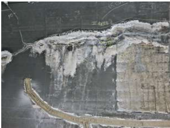
ひび割れ沿いのうき
