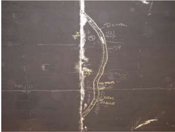
横断目地部に閉合するひび割れ
