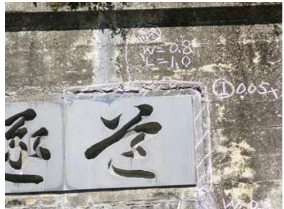
トンネル名板周辺部のうき
