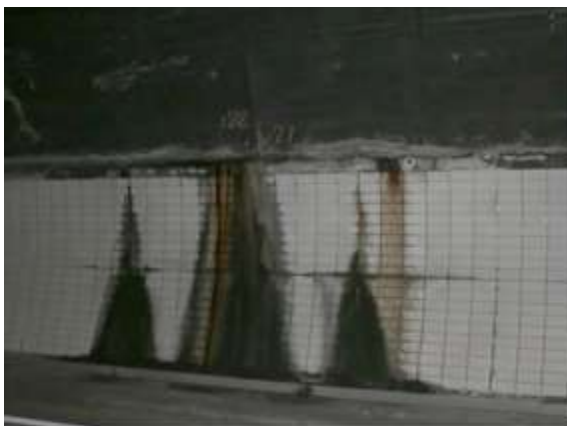
水平打継目部からの漏水
