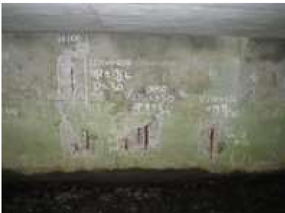
①側壁部のうき、はく離(鉄筋露出)
