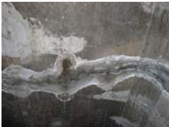
②頂版部のひび割れと漏水
