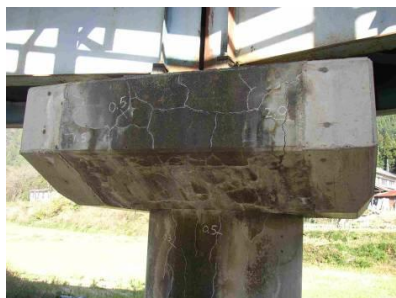
対策前(建設後28年経過)
