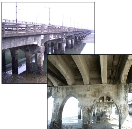
国道190号 厚東川大橋(山口県宇部市藤曲) ・1935年建設 (コンクリート橋) ・塩害による主桁、下部工の損傷が激しいため、 1997年架替 (経年数63年)
