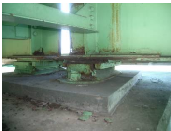
対策前(建設後37年経過)
