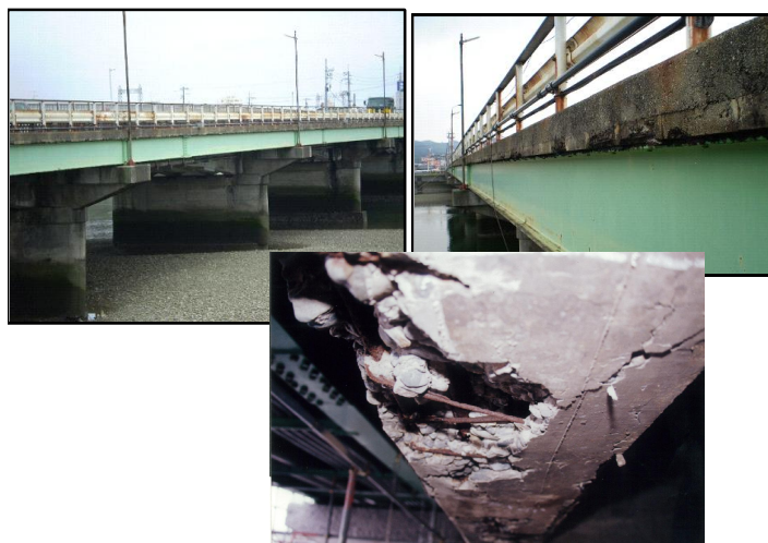
国道188号 新寿橋(山口県岩国市川下町) ・1953年建設 (コンクリート橋+鋼橋) ・主桁、下部工の損傷が激しいため、 2007年架替 (経年数55年)
